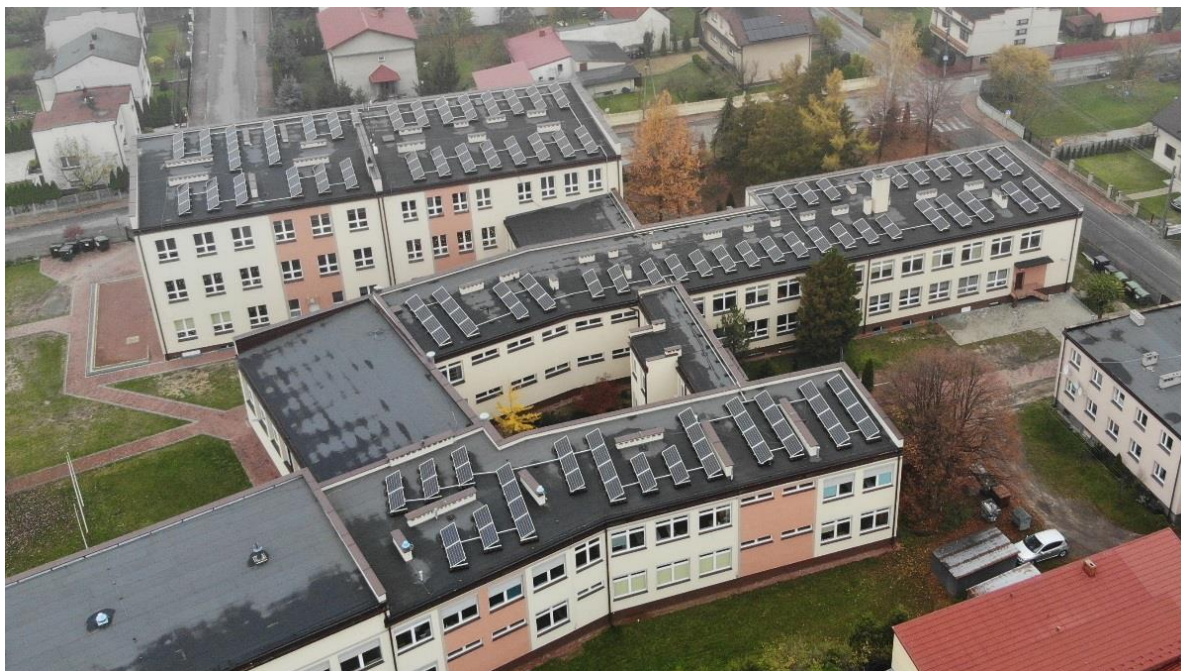
Zdjęcie 8. Instalacja fotowoltaiczna na budynku Zespołu Szkolno – Przedszkolnego w Miedźnie
