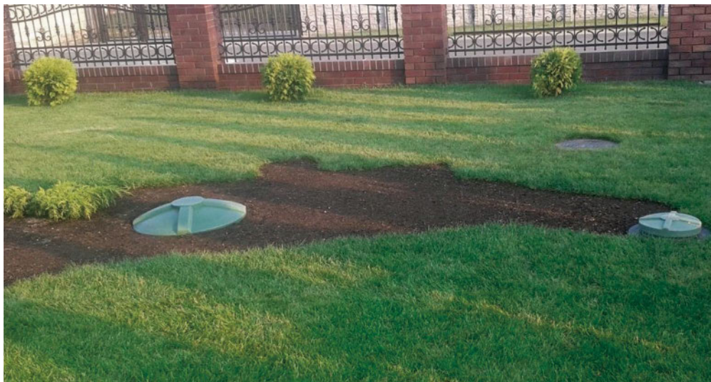
Zdjęcie 79 Zamontowana przydomowa oczyszczalnia ścieków w ramach dotacji gminnej
